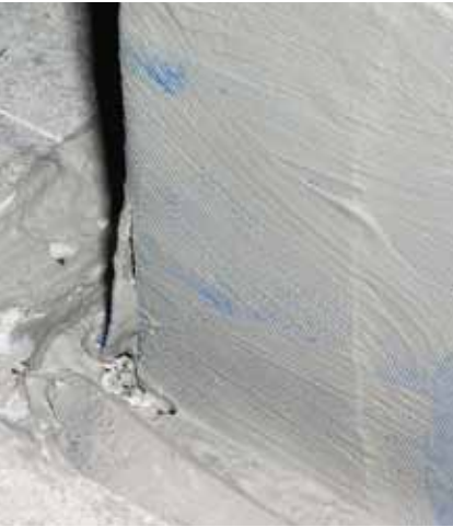
Unsachgemäße Eindichtung ohne Formteile (90°-Außenecke).
